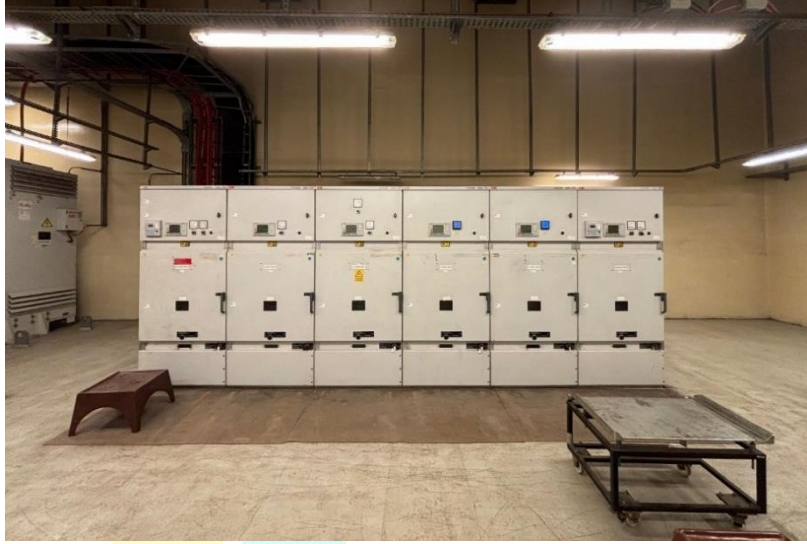
Şekil 10 - M4 Metrosuna ait OG hücreleri
